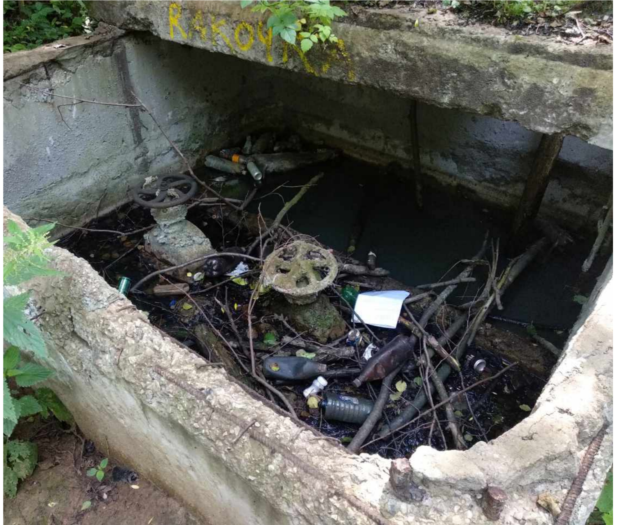
ПОЛУЗАТОПЛЕННАЯ КАМЕРА КАНАЛИЗАЦИОННОГО КОЛЛЕКТОРА
